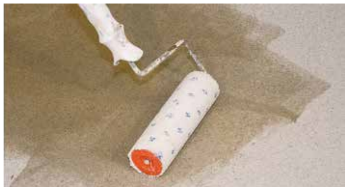
Zdjęcie 10. Gruntowanie posadzki betonowej: aplikacja przy użyciu pacy gumowej, a poziomowanie za pomocą wálka.
