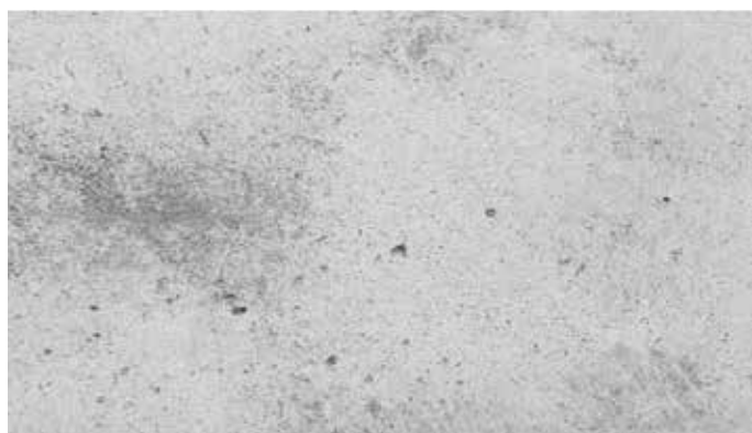
Zdjęcie 6. Różne typy dziur i pęknięć na powierzchniach nieimpregnowanych posadzek betonowych.
